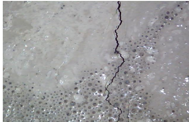
شکل ۴: تصویر دیجیتالی از محل ترک خوردگی در دال بتنی
